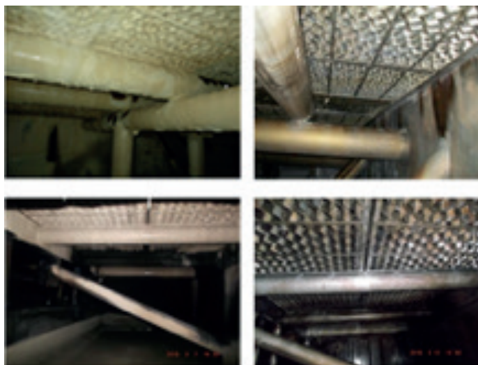
Imagem 1 - Preenchimento do condensador barométrico antes e após a limpeza química.
